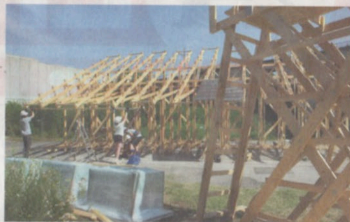
La structure en construction fera office à la fois de travail pratique et de lieu de rendez-vous culturel. DOMINIC FAVRE
